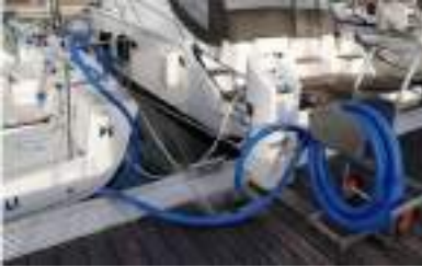
Equipement d'aspiration des eaux noires © internet
