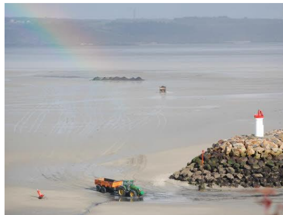
Transfert des sédiments de dragage du Port du Légué par des camions dumpers (crédit : Ouest France)
